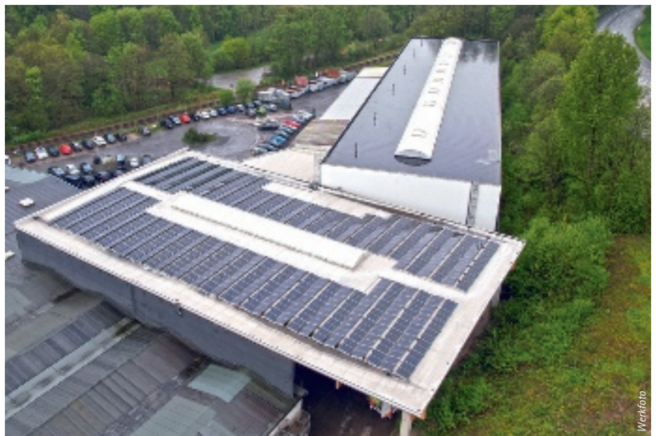
Die neue PV-Anlage ist ein wichtiges Zeichen in puncto Nachhaltigkeit.
